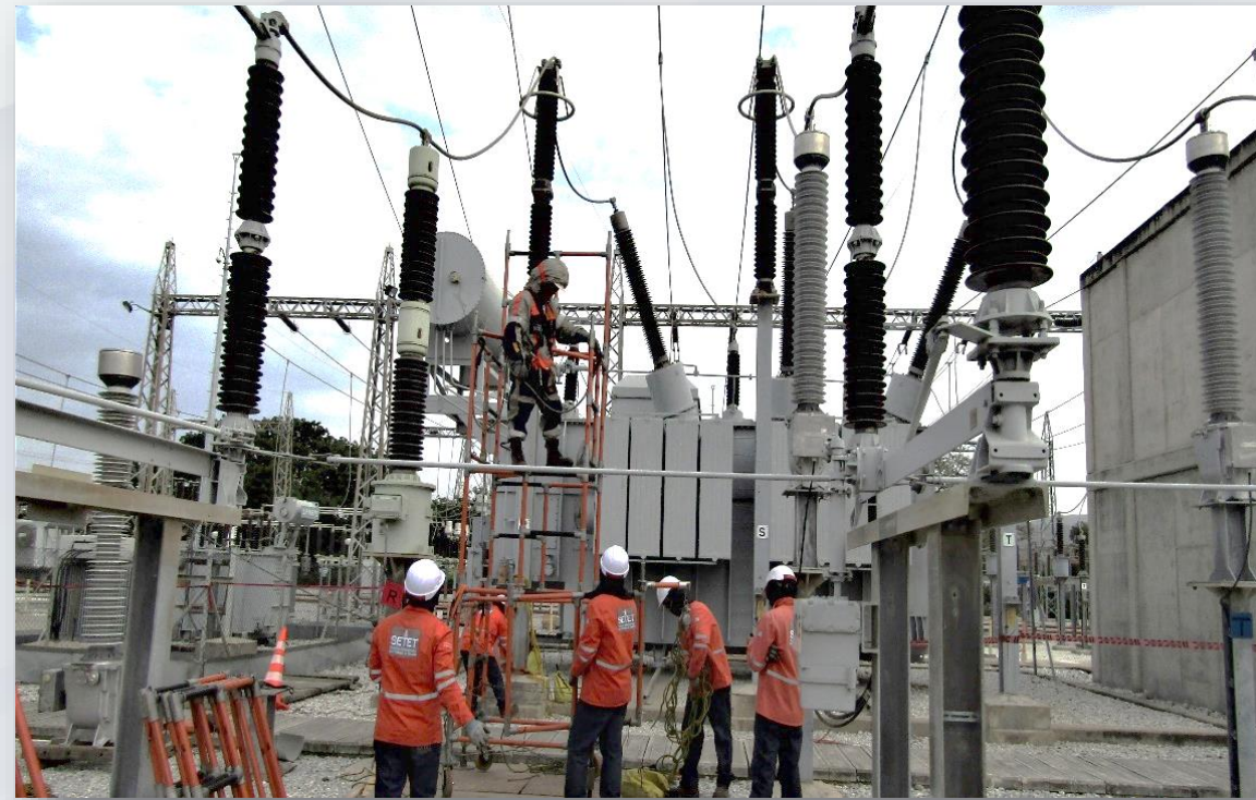
Subestación Santa Marta
