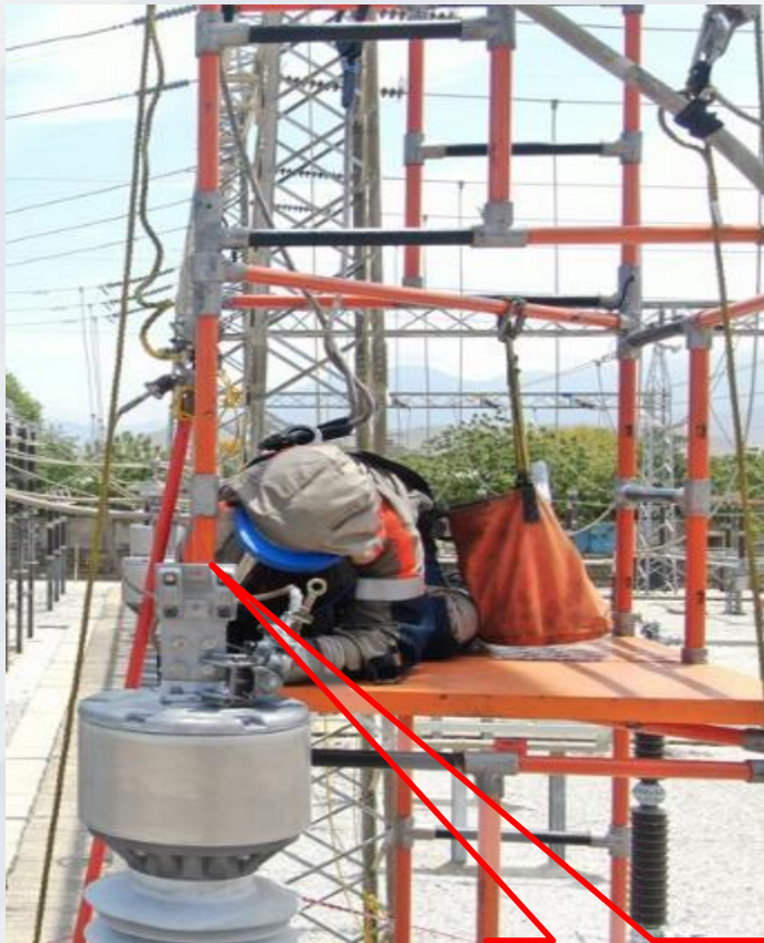
Preparación conexión Potencia TP
