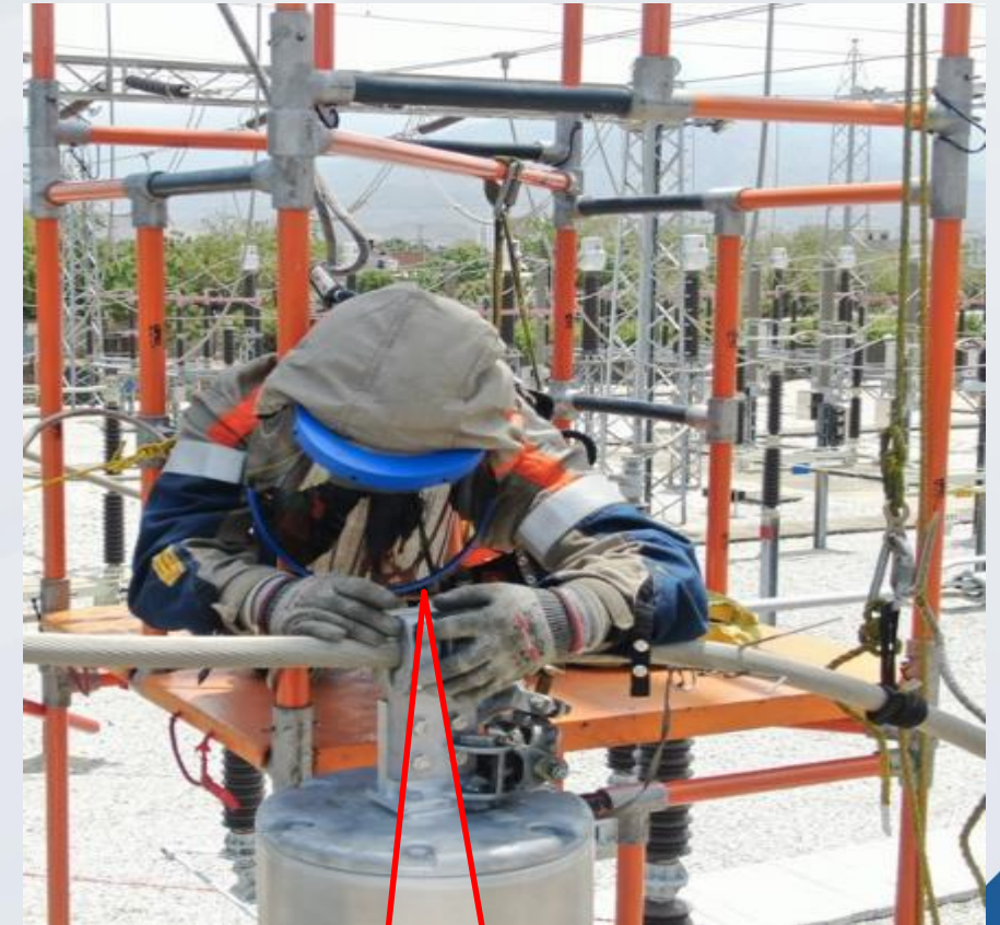
Armado conector potencia TP
